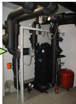
Wärmetauscher im Winterbetrieb
