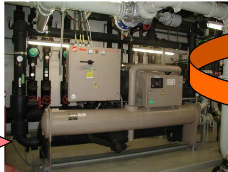
Kältemaschine im Sommerbetrieb
